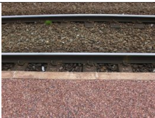
Absence de dalles podotactiles
